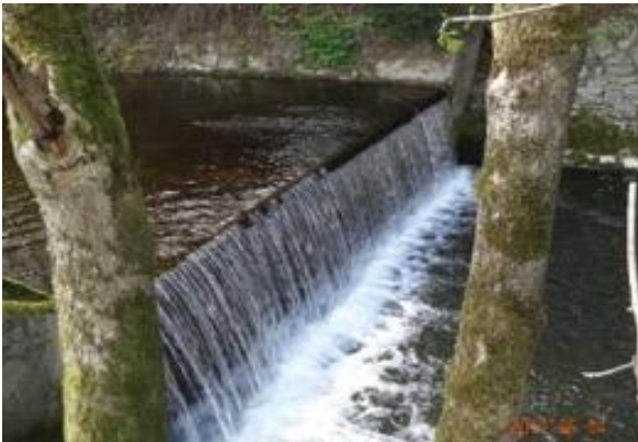
Absturz > 1 m (Foto: LANUV NW)
