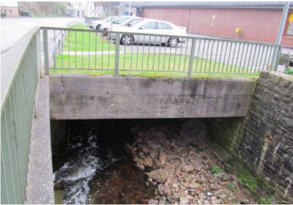
Verrohrung > 20 - 50 % mit Sediment (Foto: LANUV NW)
