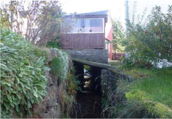
Verrohrung 10 - 20 % mit Sediment (Foto: LfULG SN)
