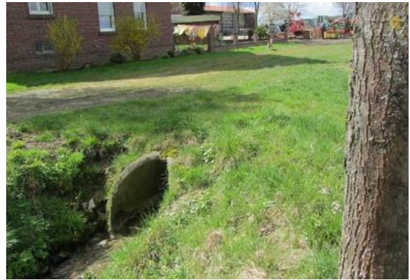
Verrohrung > 20 - 50 % ohne Sediment (Foto: LANUV NW)
