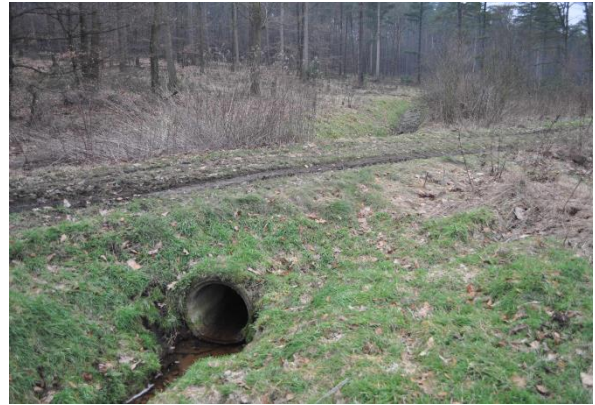
Verrohrung 10 - 20 % ohne Sediment (Foto: S. Haarnagell)
