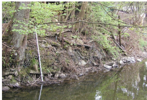
wilder Verbau (Foto: Planungsbüro Koenzen)
