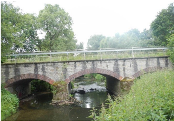
Durchlass, Lauf verengt mit Sediment (Foto: Planungsbüro Koenzen)
