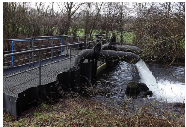
Schöpfwerk/Pumpwerk (Foto: LANUV NW)
