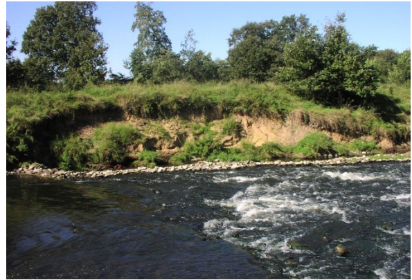
Abbruchufer (Foto: Planungsbüro Koenzen)
